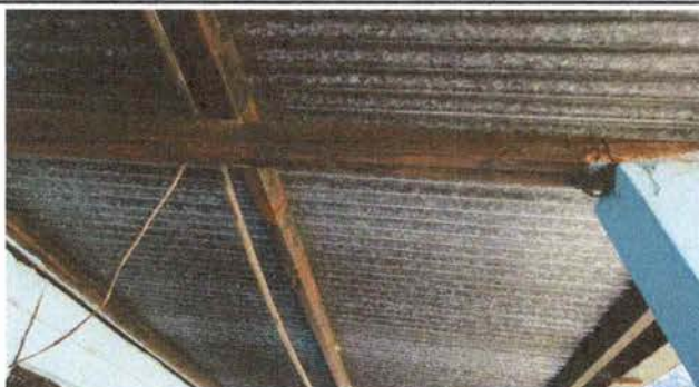
Foto 5: Estructura de soporte de metal modulo 1
