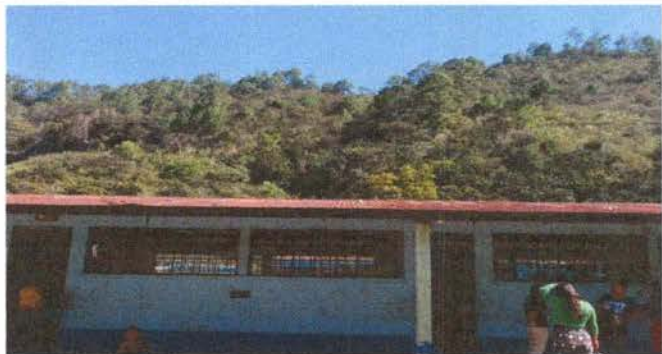
Foto7: Paredes en mal estado su pintura (exterior)
