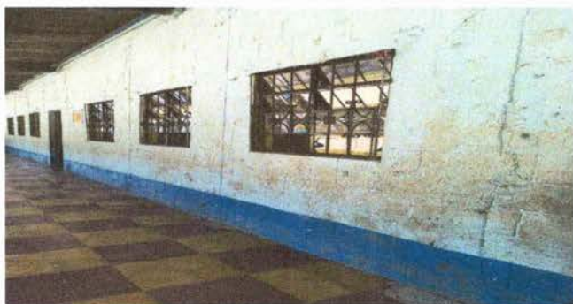
Foto 9: Pintura en mal estado (exterior)
