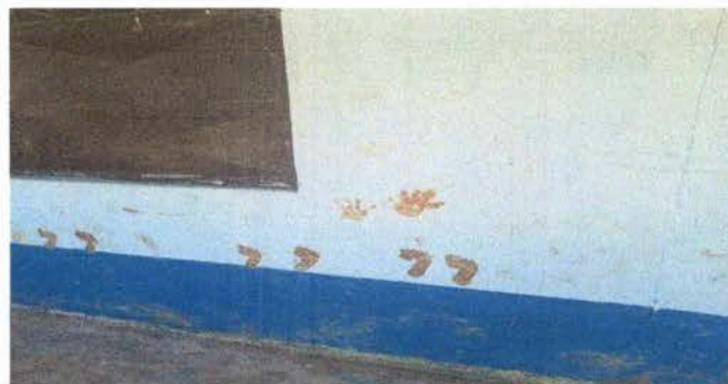
Foto 8: Pintura en mal estado
