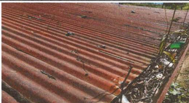
Foto 3: Canal deteriorado modulo 1
