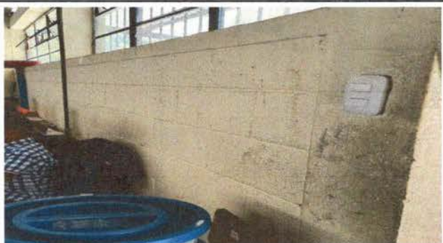
Foto11: Pintura en mal estado (interior)
