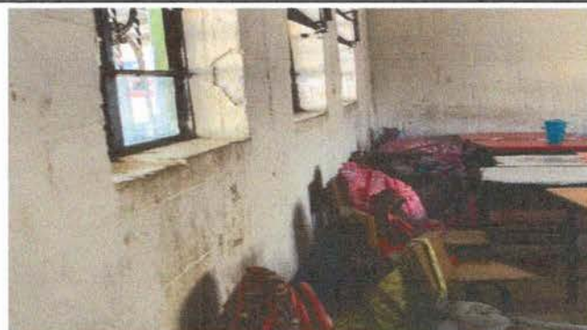
Foto 10: Pintura en mal estado (interior)
