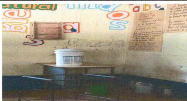
Foto 12: Pintura en mal estado (interior)
